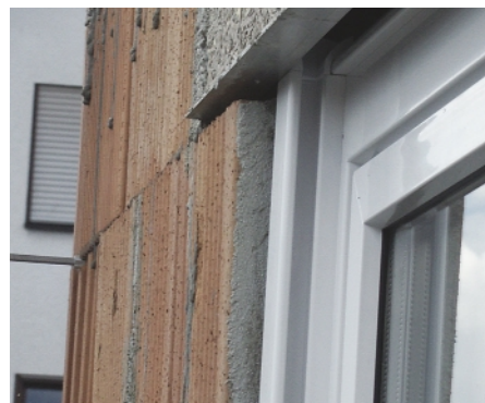
Bild 6: Ungünstig: Der Mauerbündige Rolladenkasten erschwert die Überdämmung des Fensters
