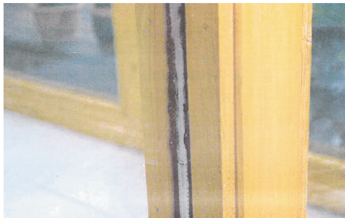
Bild 1: Schadensbild – Eindringen von PIB-Primärdichtung in den SZR
