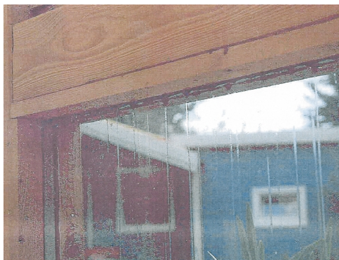
Bild 2: Schadensbild – Extremfall Austritt von Weichmacher aus der Primärdichtung in den SZR
