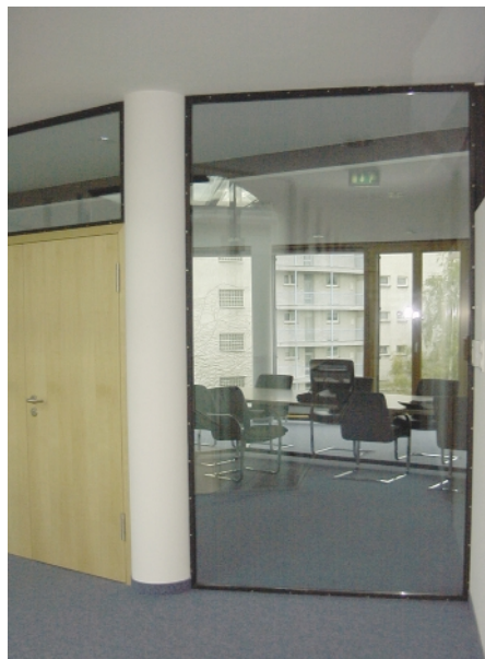
Bild 1: Eine raumhohe F 30-Verglasung mit dem Brandschutzglas „Contraflam“ von Vetrotech Saint-Gobain
