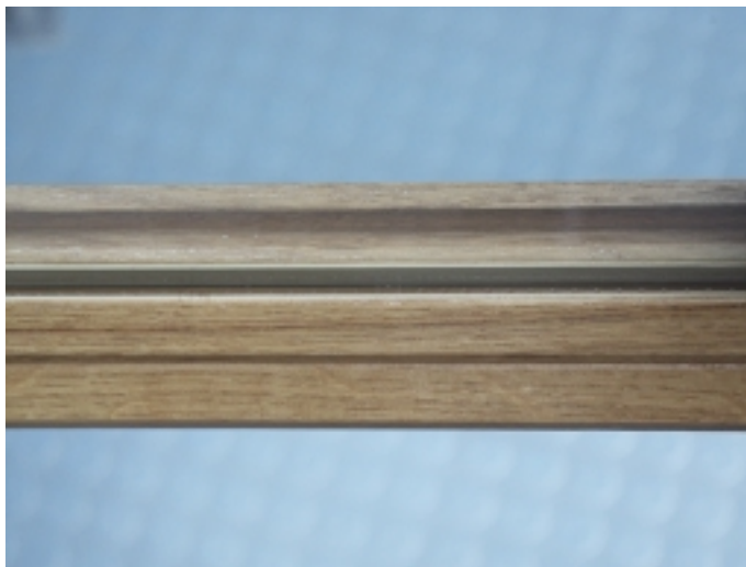
Bild 9: Hier wurde ein 3-4-:3 – Sonder-Isolierglas mit Leinölkitt abgedichtet. Diese Anwendung ist nur mit Verträglichkeitsnachweis möglich
