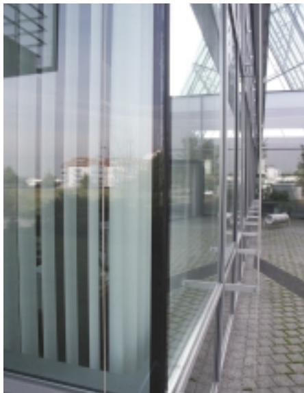
Bild 1: Eine Ganzglas-Ecke ist zwar architektonisch reizvoll, aber technisch nicht unproblematisch
