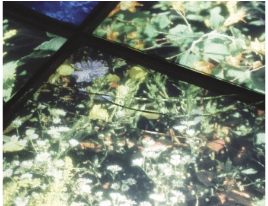
Foto aus dem Gutachten – Beispiel eines Glasbruchs
