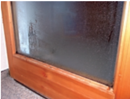
Bild 2: Nach dem Einbau von neuen Fenstern im Rahmen von Sanierungsmaßnahmen treten häufig Tauwasser- und Schimmelbildung auf, wenn die Feinlüftung nicht zureichend ist
