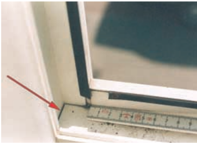
Bild 2: Bei dem Öffnungsflügel der Wintergartenkonstruktion ist auf einer Seite die Dichtung um 20 mm zu kurz. Darüber hinaus kann Wasser in die Konstruktion eindringen (Pfeil), da die Kopplungsstöße der Pfosten und Riegel untereinander nicht abgedichtet sind
