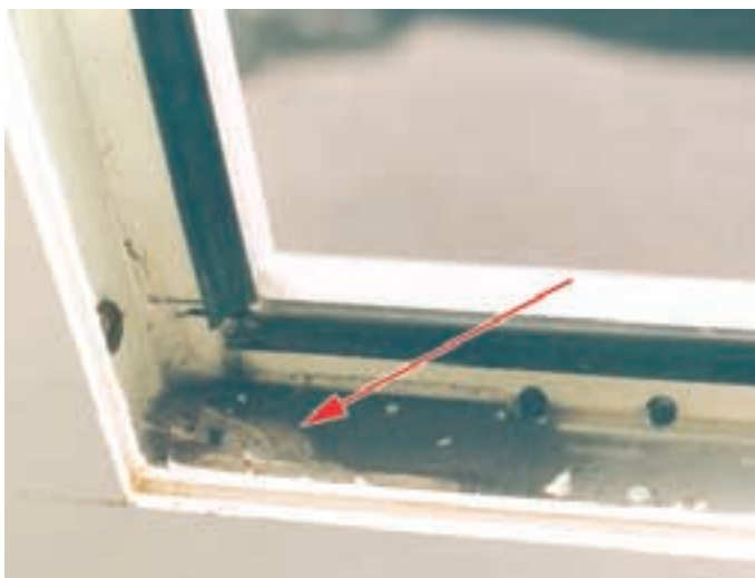
Bild 3: An den Staubansammlungen (Pfeil) läßt sich der Wasserfluß innerhalb des Glasfalzes erkennen. Unter der Querdichtung sind zwei Löcher (unten rechts) zur Wasserableitung zu sehen, es wurde versäumt, diese zu verbinden. Auf der Außenseite ist nur ein Loch vorhanden – das ist mangelhaft und nicht ausreichend
