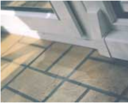
Bild 4: Vor der Türe hat sich eine Wasserlache gebildet
