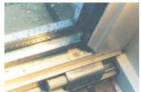
Bild 7: Auch hier Wasser im Glasfalz, die Hälfte der erforderlichen Öffnungen für den Dampfdruckausgleich fehlt
