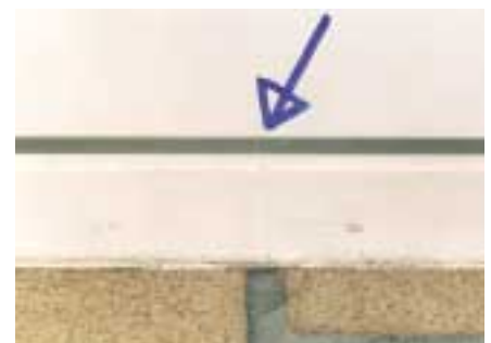
Bild 3: Auch im unteren Bereich der Türe (Mitte) erfolgt ein Wassereintritt
