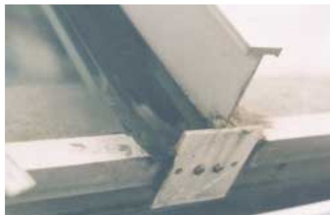
Bild 9: Am unteren Dachrand ist ein Aluminium-Winkelprofil aufgesetzt, das den Wasserablauf behindert und zur Glasscheibe hin nicht dicht ist. Die eingebrachte Versiegelung ist auf Dauer nicht dicht, da sie ständig im Wasser liegt
