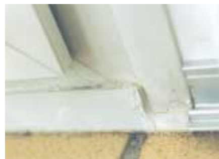
Bild 2: Die untersuchte Ecke ist undicht und läßt Wasser durch
