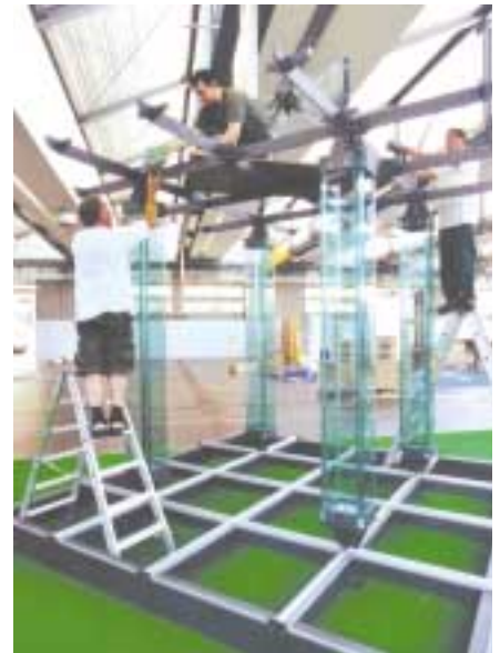
Der Glaspavillon von Hera Glas wurde als eine statisch tragende Glaskonstruktion entwickelt. Die schnelle Montage ist ein wesentliches Merkmal der 1:1-Glas-Studie
