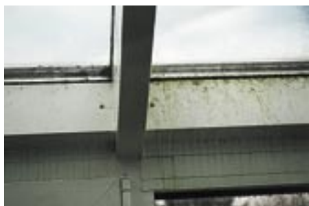
Leistungsstarke Geräte verhindern derartige Schwitzwasserbildung
