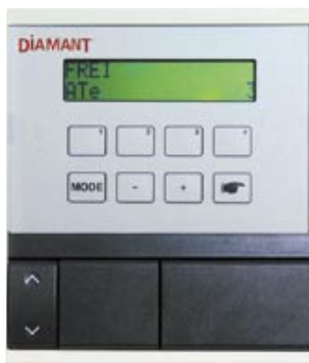
Die Wintergartensteuerung sorgt für reibungsloses Zusammenspiel von Heizung, Be- und Entlüftung und Schattierung
