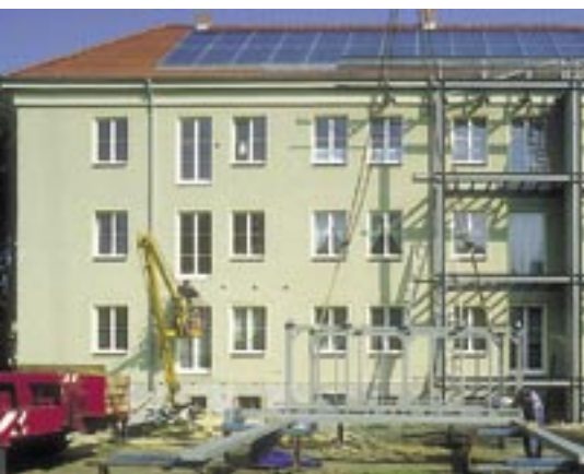
Bild 1: Der Einbau neuer Fenster in Altbauten erfordert von Fensterbauern und Monteuren entsprechendes Know-how, besondere Sorgfalt sowie Fingespitzengefühl
