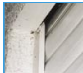
Bild 3: Der Auslassschlitz (ca. 20 mm breit) für den Rollladenpanzer auf der Außenseite wird durch die Schrägstellung des obersten Rollladenstabs vergrößert
