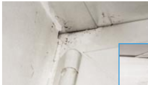
Bild 1: Die Rollkastendeckel liegen in den Eckbereichen rechts und links nicht an und lassen Luft durch
