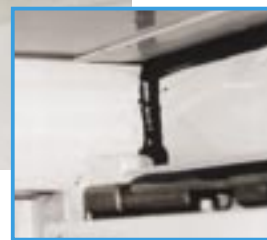
Bild 2: Bei allen Rollläden ist die Ausbildung der Kopfanschlüsse nicht fachgerecht
