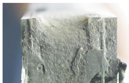
Bild 2: Isolierglasrandverbund im Eckbereich
