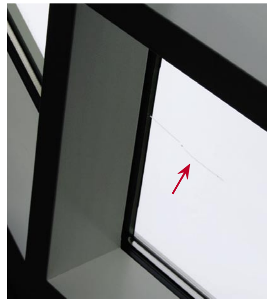
Bild 2: Ansicht des von der Oberkante ausgehenden Risses
