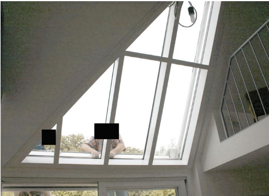
Bild 1: Ansicht der Überkopfverglasung des Wohnraumes mit der gesprungenen Scheibe
