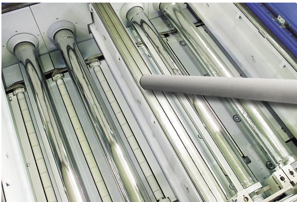
„AR-Magnetron“-Doppelkathoden – montiert in einer Glasbeschichtungsanlage
