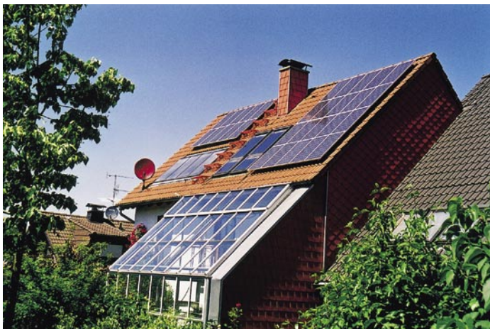
Solarthermie und Photovoltaik sind beide unverzichtbar. Deshalb werden auf den Hausdächern beide Anlagentypen installiert sein
