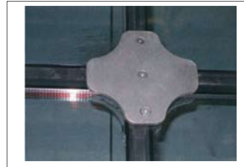
Sichtbare mechanische Sicherung
