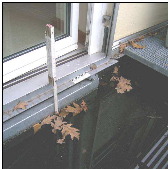
Abb. 2.5.1-4: Anschlusssituation, bei der Besichtigung wurde der Gitterrost vor der Tür entfernt
