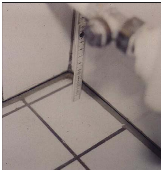
Abb. 3.3.3-2: Absenkung des Belags in der Raumecke
