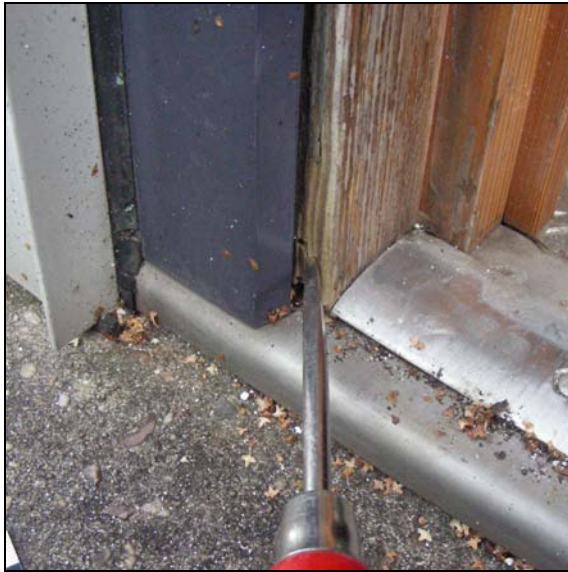
Abb. 2.3.5-4: Feuchtigkeitsschäden an den Rahmenstielen der Tür
