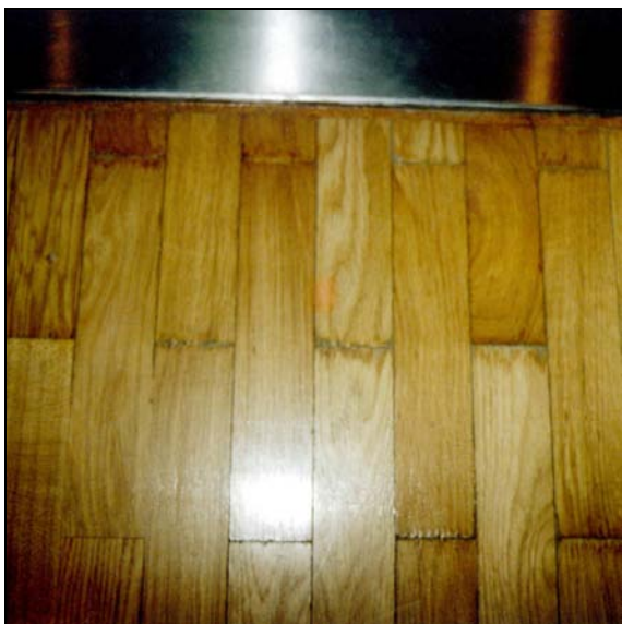
Abb. 3.3.2-4: Feuchtigkeitsschäden am Parkettboden
