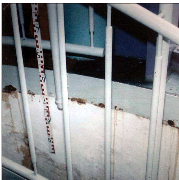
Abb. 2.3.2-4: Schäden im Bereich des Hauseingangs am Treppenabgang
