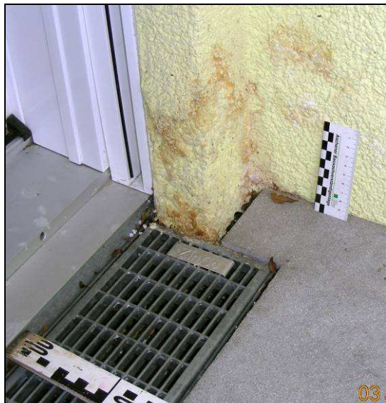
Abb. 2.3.1-2: Balkonschwelle (nicht niveaugleich)
