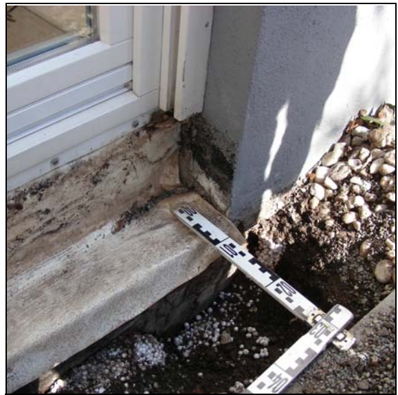
Abb. 2.3.3-5: Unzureichende Abdichtungsmaßnahmen am Türanschluss
