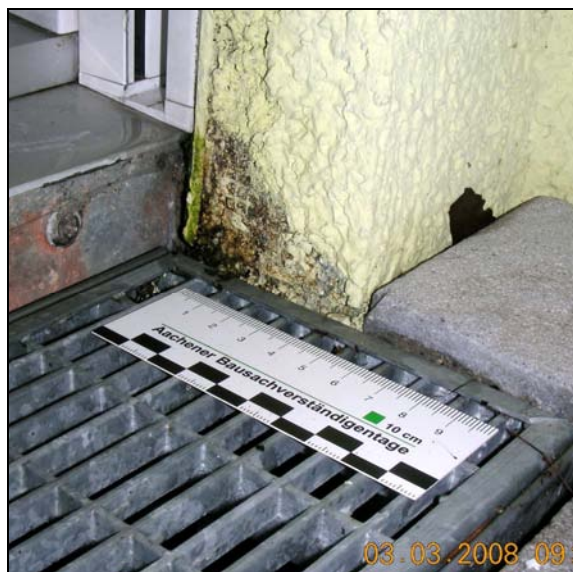
Abb. 2.3.1-4: Deutliche Durchfeuchtungen und Veralgungen entlang der Türschwelle im Leibungsbereich
