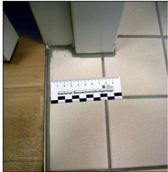
Abb. 3.3.1-2: Leichte Durchfeuchtungsschäden am anschließenden Parkettboden
