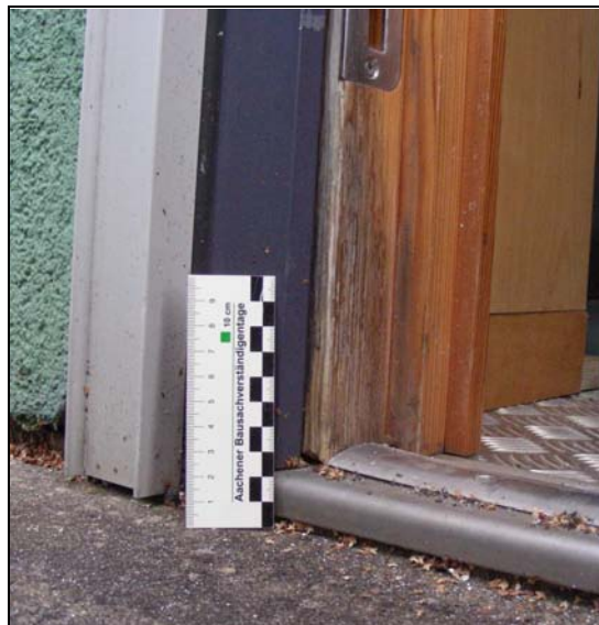
Abb. 2.3.5-2: Die Rahmenstiele der Holzür sind bereits durch Feuchtigkeitseinwirkung zerstört.
