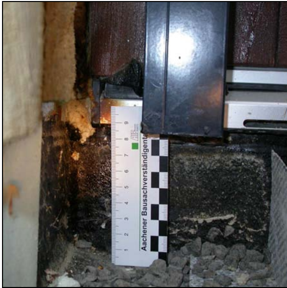
Abb. 2.3.4-4: Im unmittelbaren Eckbereich liegt die Flüssigabdichtung auf der Polyurethanausschäumung der Fuge zwischen Türrahmen und Rohbauanschluss auf und ist nach oben hin offen.
