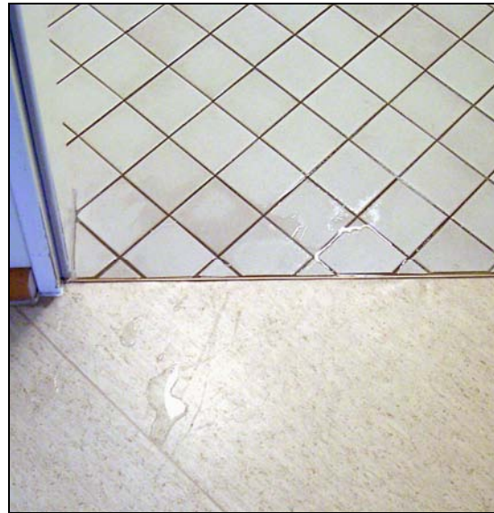
Abb. 3.5.1-2: Feuchtigkeitsbeanspruchung der Schwelle
